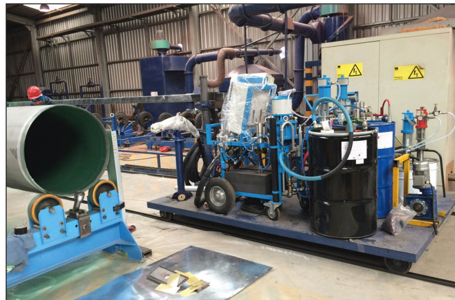
Instalación realizada por DISNAMAIR en el año 2015, en Santiago de Chile para el pintado de tuberías. Sistema WIWA de aplicación en caliente, para revestimiento exterior e interior con poliuretano 100% sólidos y de curado rápido (unos 15"). Consigue altos micrajes (1.000 exterior y 600 micras interior por mano).
